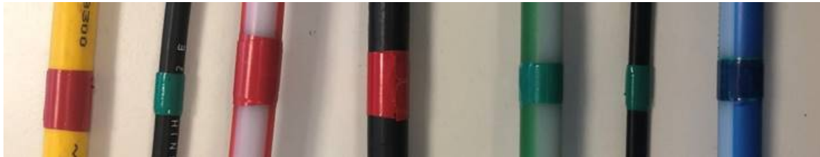
Abbildung 7: Beispielhafte Beschriftung an verschiedenen Kabeln
