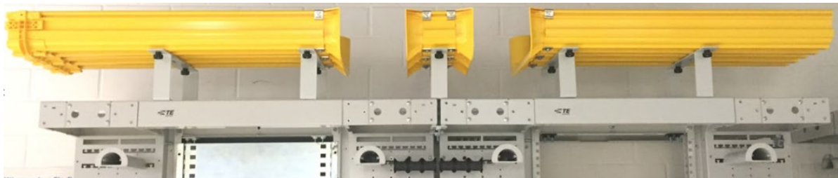
Abbildung 18: Horizontales Verbindungskabelmanagement Fa. CommScope (Fiberguide)
